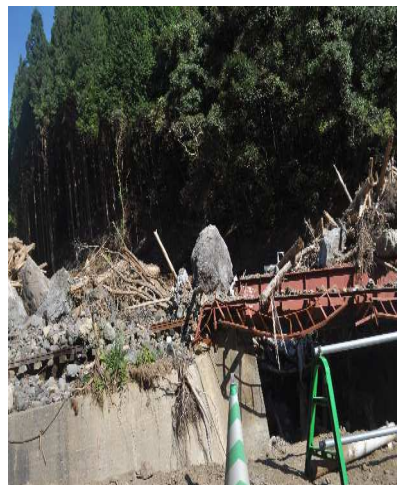
第一橋梁近くにある小さな橋梁 土砂と大きな岩が山積！
