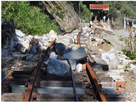
球泉洞駅・駅舎・ホームも崩壊
