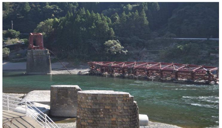
土台から流された球磨川第一橋梁！
