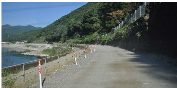
道路が使用でき無い為、線路を埋めて道路にしている。
